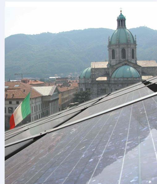
Impianto solare fotovoltaico (Como, via Pessina)
