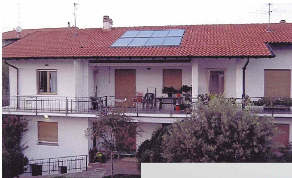
Impianto solare termico
