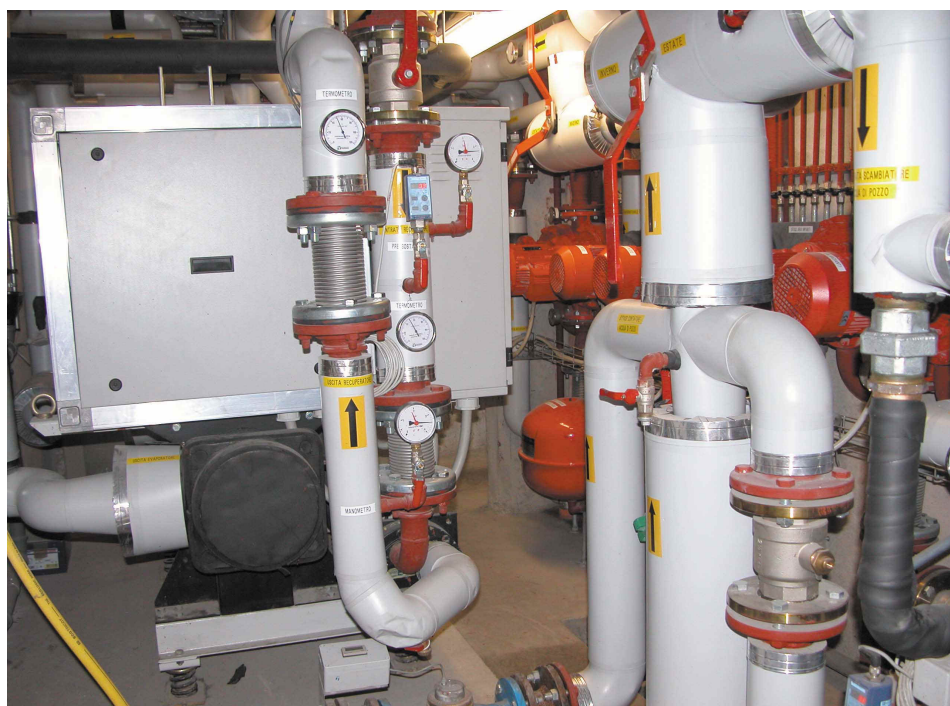
Sistemi di produzione calore ad alto rendimento (Como, via Pessina: impianto a pompa di calore alimentato anche da sistema fotovoltaico)
